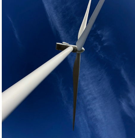
Corti I Wind Farm, 100 MW, Bahía Blanca, Buenos Aires Photo: courtesy of EOS Energía.
